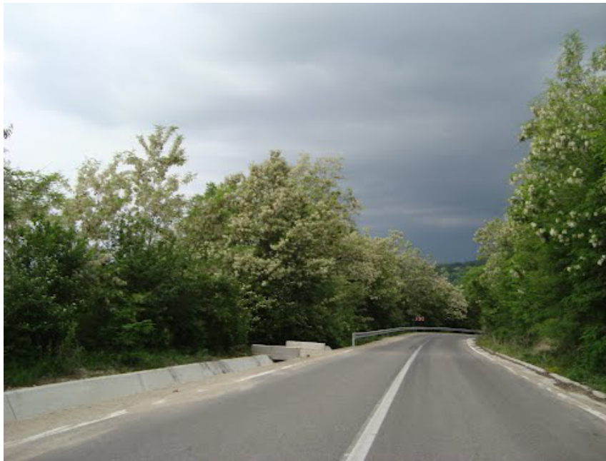
Figura nr. 11 – Starea actuala a Drumului Nordului
